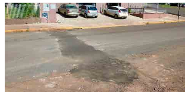
Buraco foi fechado pela Secretaria de Obras no mesmo dia
