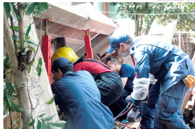
Homem realizava a retirada de palanques que sustentavam a obra quando a laje cedeu sobre ele
