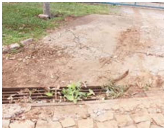
Grade que deveria coletar a água está entupida
