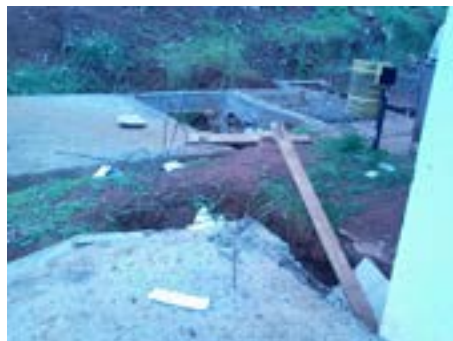
Obra encontra-se parada aguardando solução de desabilitação da empresa
