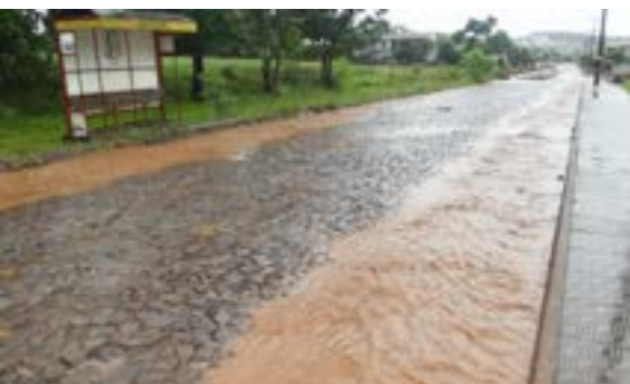
Rua tinha vários problemas com alagamentos
