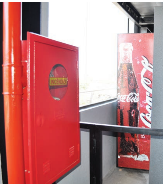
Possuí todo o sistema de combate a incêndio
