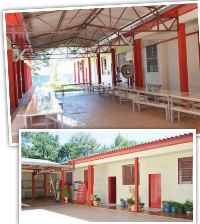
Para a escola, já há projetos para reforma do ginásio e ampliação da área coberta e refeitório
