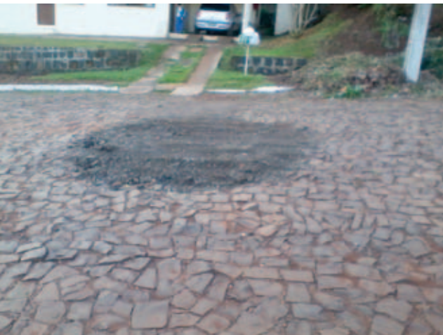
Remendos foram feitos no calçamento
