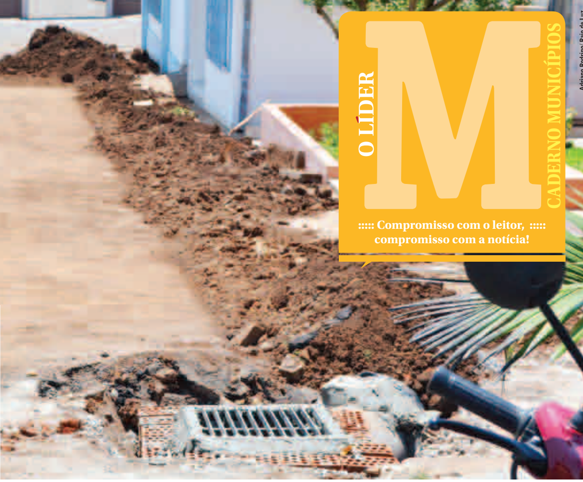
Na última semana, o asfalto novo foi rompido para novas obras. Agora, conforme a Administração Municipal, a empresa vencedora da licitação está resolvendo o problema e arcando com os prejuízos
