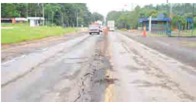
Imagens mostram a evidente degradação das BRs da região
