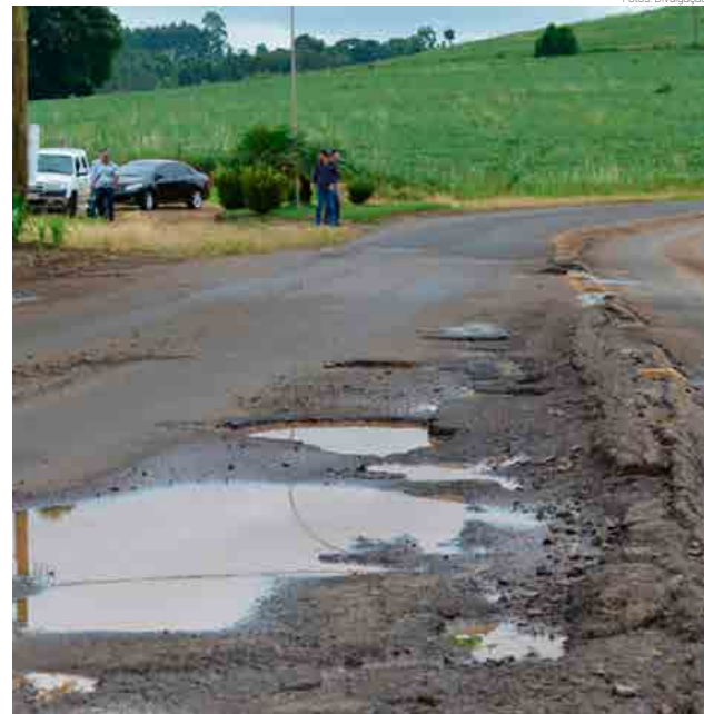
Trechos da rodovia SC-160 estão precários
