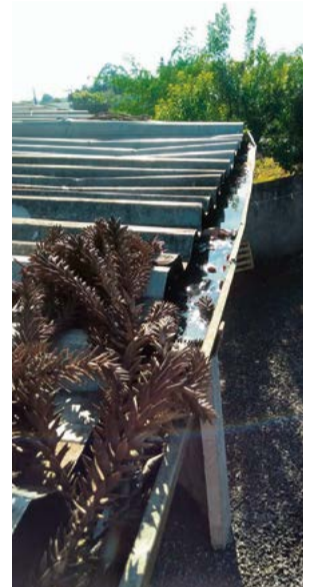
Calha com sujeira e acúmulo de água foi localizada em residência do município
