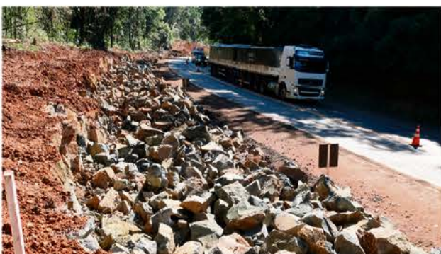
Terceira pista é construída no sentido Maravilha a São Miguel do Oeste, nas proximidades do Acampaz.
