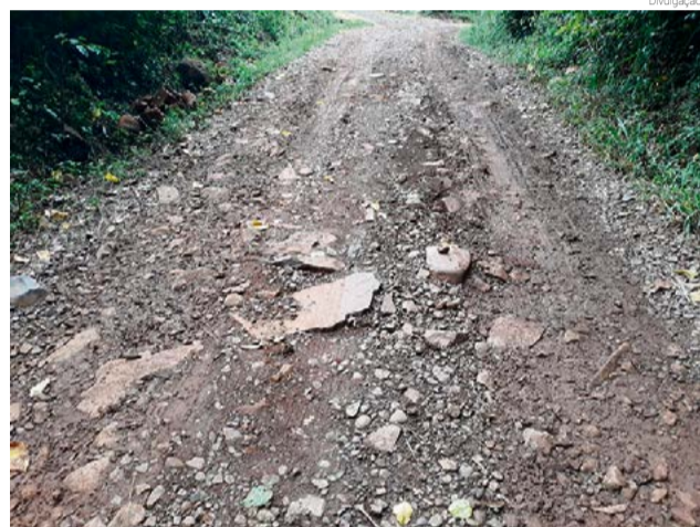
Estrada na Linha Três Coqueiros em péssimas condições gera protesto de moradores
