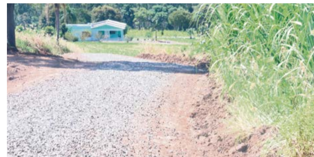
Município usa nova técnica para recuperar vias que estão em más condições no interior
