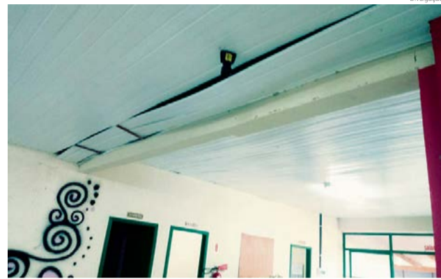
Abertura no teto por onde a água passa em dias de chuva
