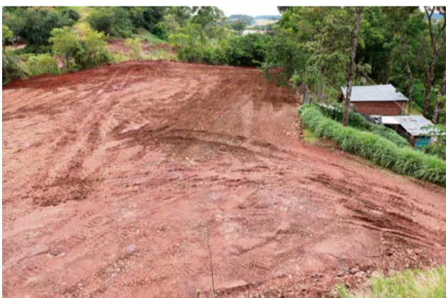
Máquinas abrem caminho e ampliaram estacionamento onde já havia área para veículos
