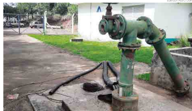
Bomba está parada e precisa de equipamentos para ser retirada
