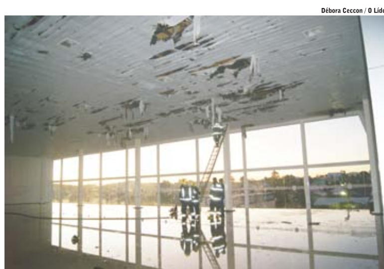
Teto da parte interna da loja de veículos foi destruído pelo incêndio
