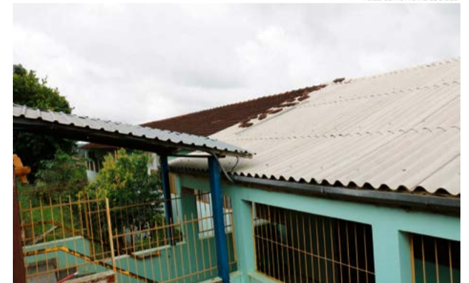
Ordem de serviço prevê troca do telhado
