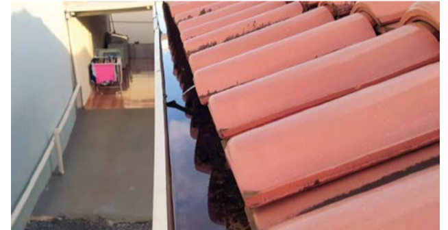
Calhas com água acumulada são um grande problema no município
