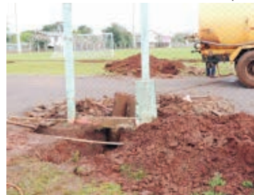
Ao promover os reparos, foram encontrados vários bueiros trancados
