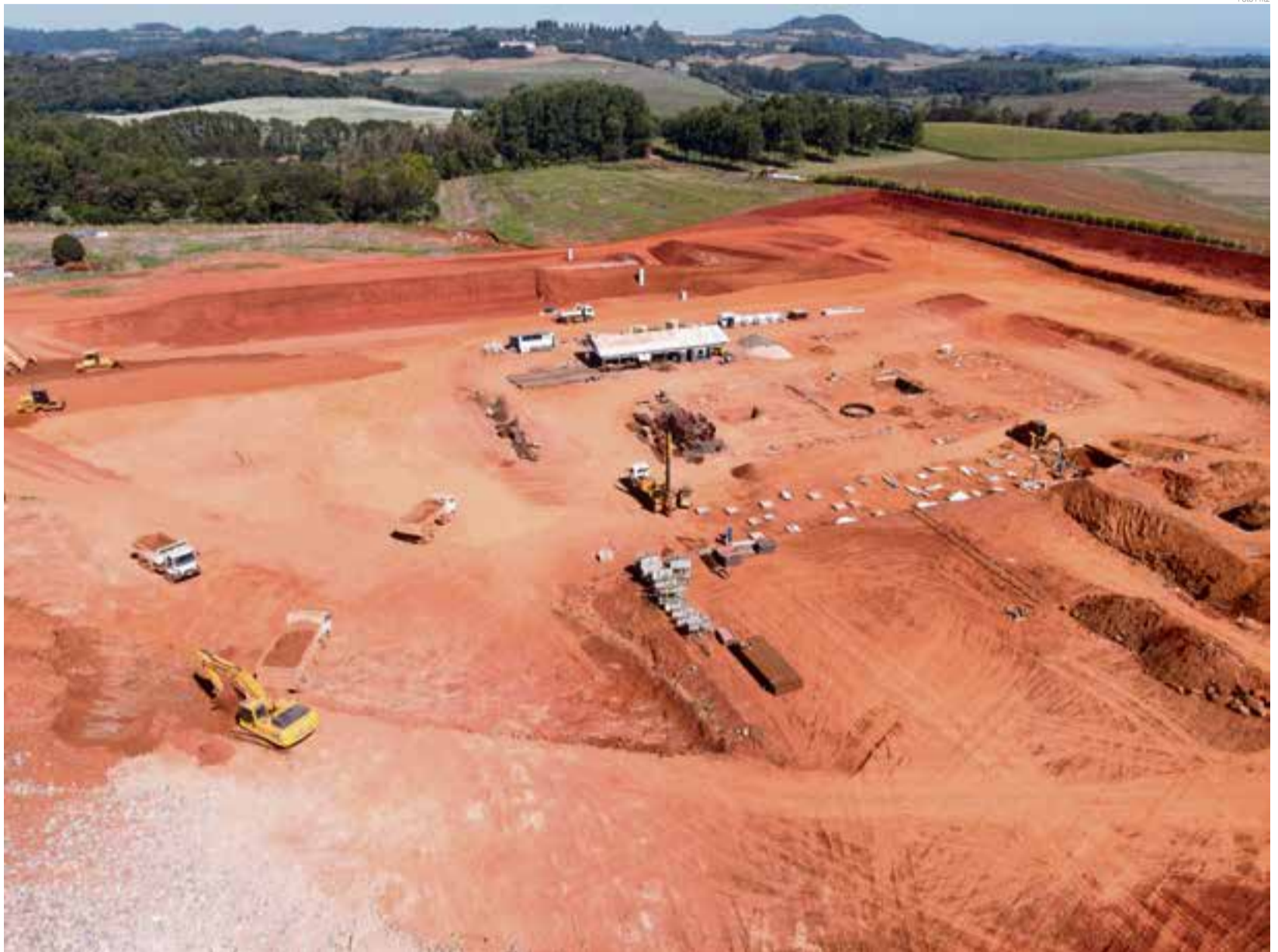
Primeira etapa do projeto está em execução e a área construída será de 8685,18 m 2
