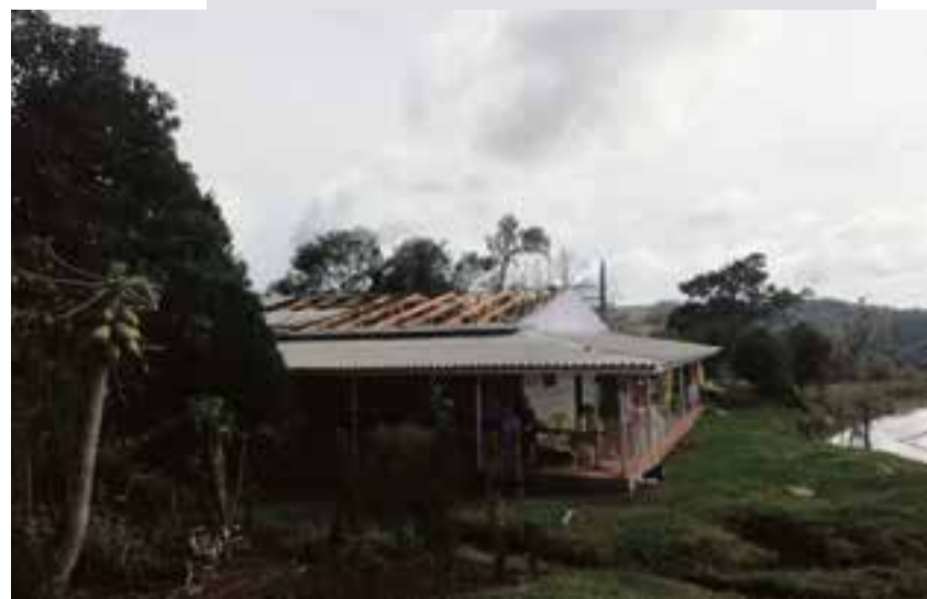
Registro de destelhamento em Flor do Sertão
