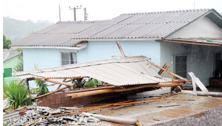
Garagem foi totalmente destruída no Bairro Cohab
