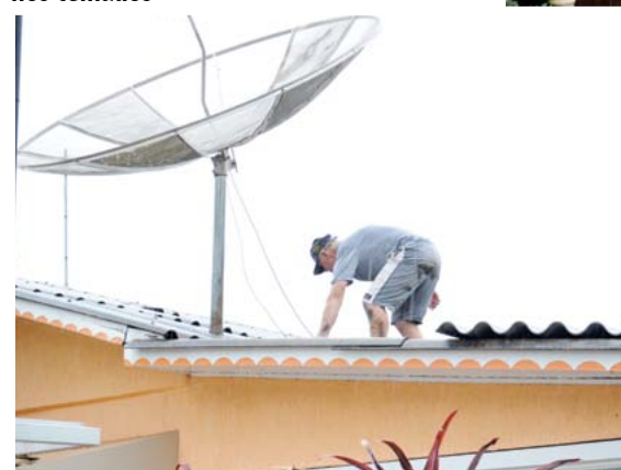
Moradores improvisaram consertos nos telhados
