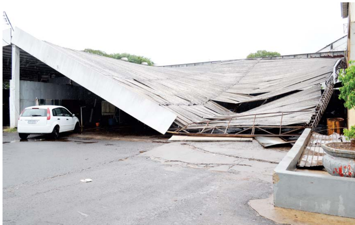
Telhado do posto de lavagem Merco Sul foi destruído pelo vento
