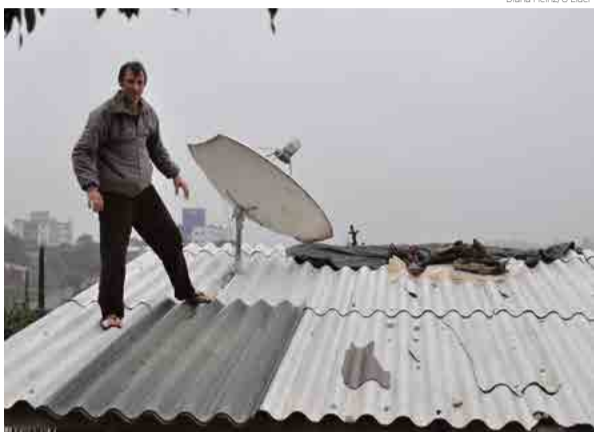
Almir Bauermann teve parte da residência destelhada na Rua Sílvio Noronha
