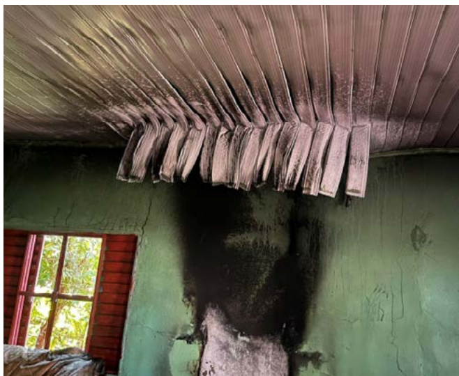
Fogo destruiu parte do forro da casa
