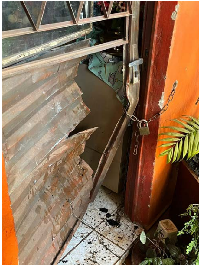
Vizinhos invadiram o local e conseguiram apagar o fogo
