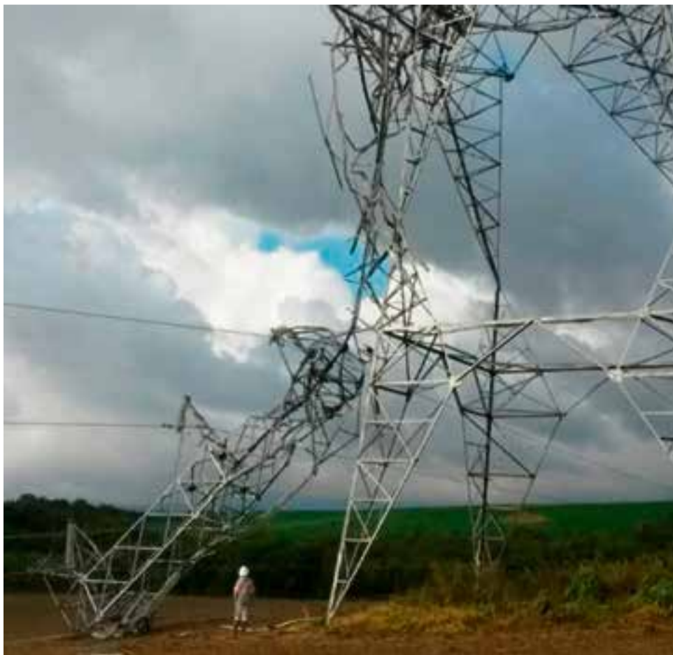
Cerca de 90 mil consumidores ficaram com o fornecimento de energia interrompido
