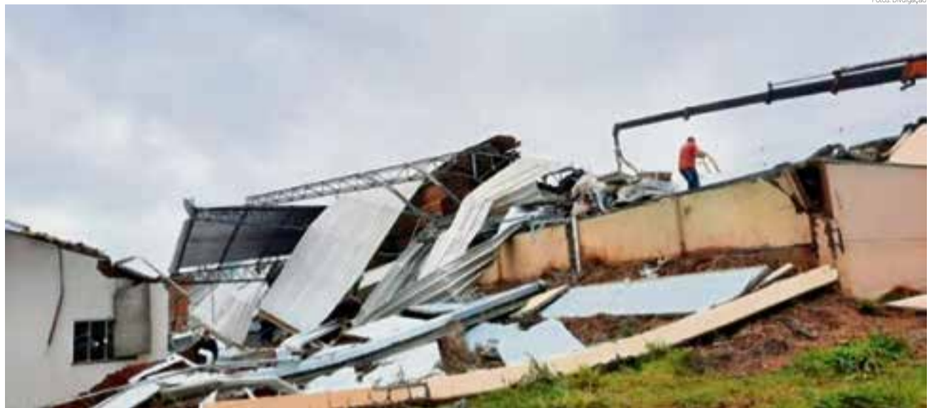
Tempestades intensas atingiram diversas regiões do território catarinense e deixou rastro de destruição por onde passou
