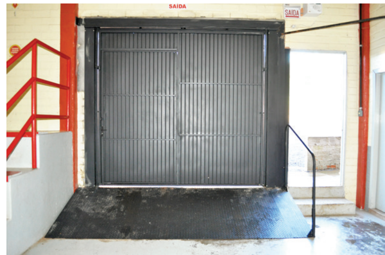
Uma das portas necessitou de rampa de acesso
