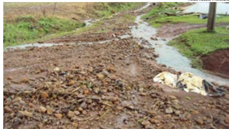
Estradas foram danificadas pela forte chuva
