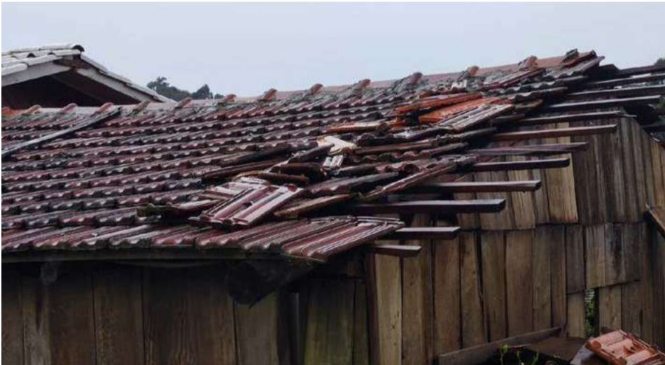
Danos em telhado, na Linha Tope da Serra
