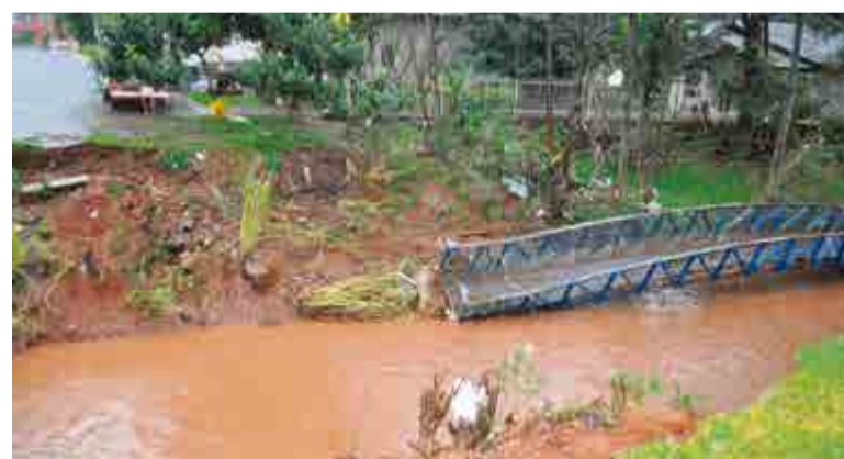
Destrução ainda pode ser vista no município
