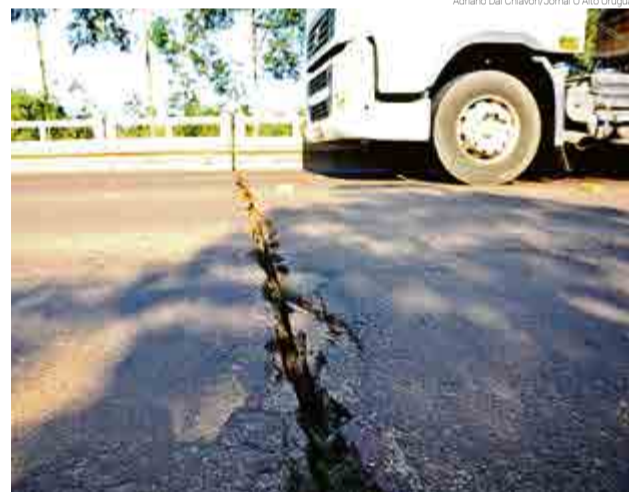
Fendas estão localizadas no primeiro e segundo pilares da estrutura
