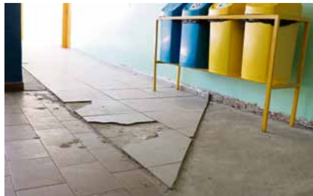
Piso novo já apresenta rachaduras
