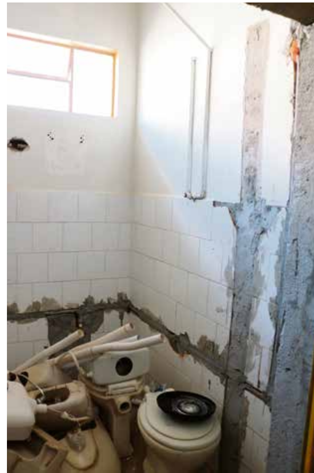
Dois banheiros não foram finalizados
