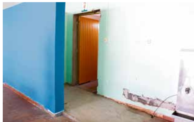
Entrada dos banheiros com rampa e paredes inacabadas
