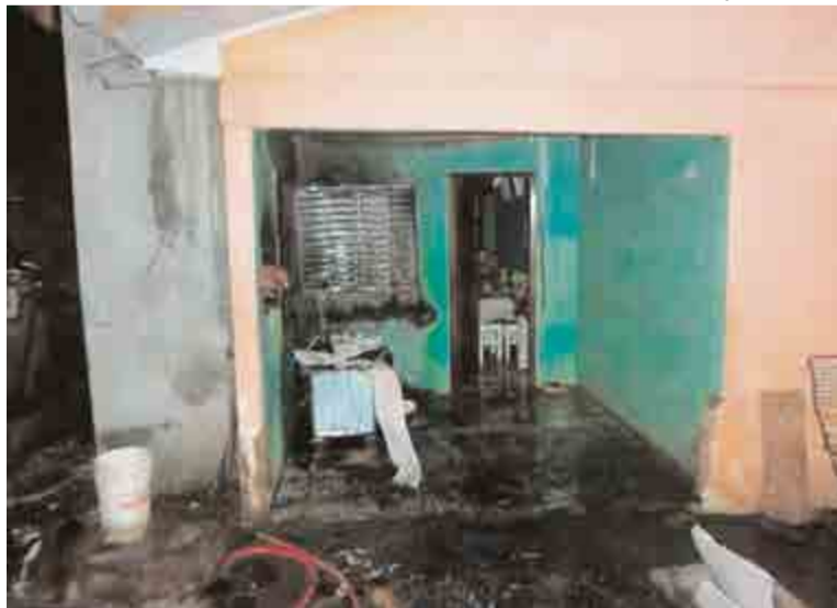
Cerca de 10m 2 da residência de alvenaria foram danificados
