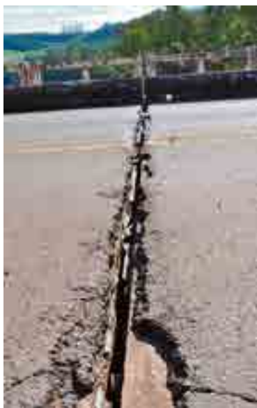
Rachaduras e balanços constantes assustam quem passa pela ponte
