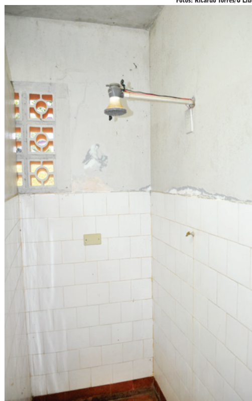
Reformas na infraestrutura são necessárias para dar condições da prática esportiva no município
