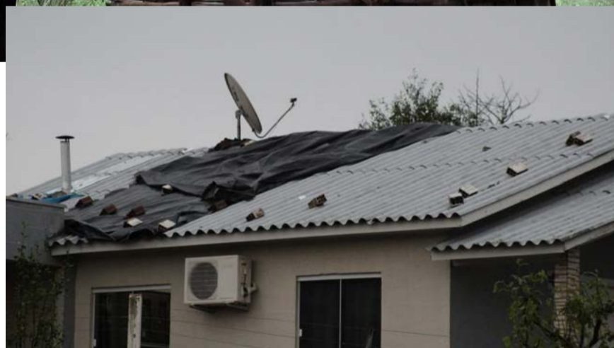
Diversas casas foram destelhadas
