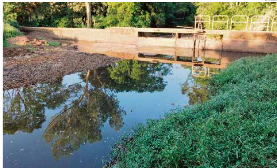
Registro mostra baixo nível de água no local de captação da Casan
