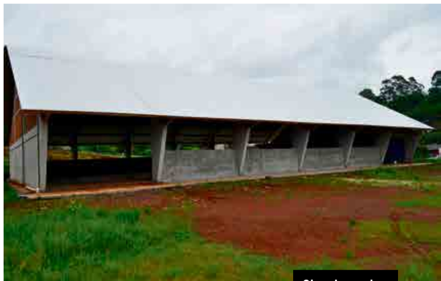
Obra da quadra coberta do Bairro Progresso está parada
