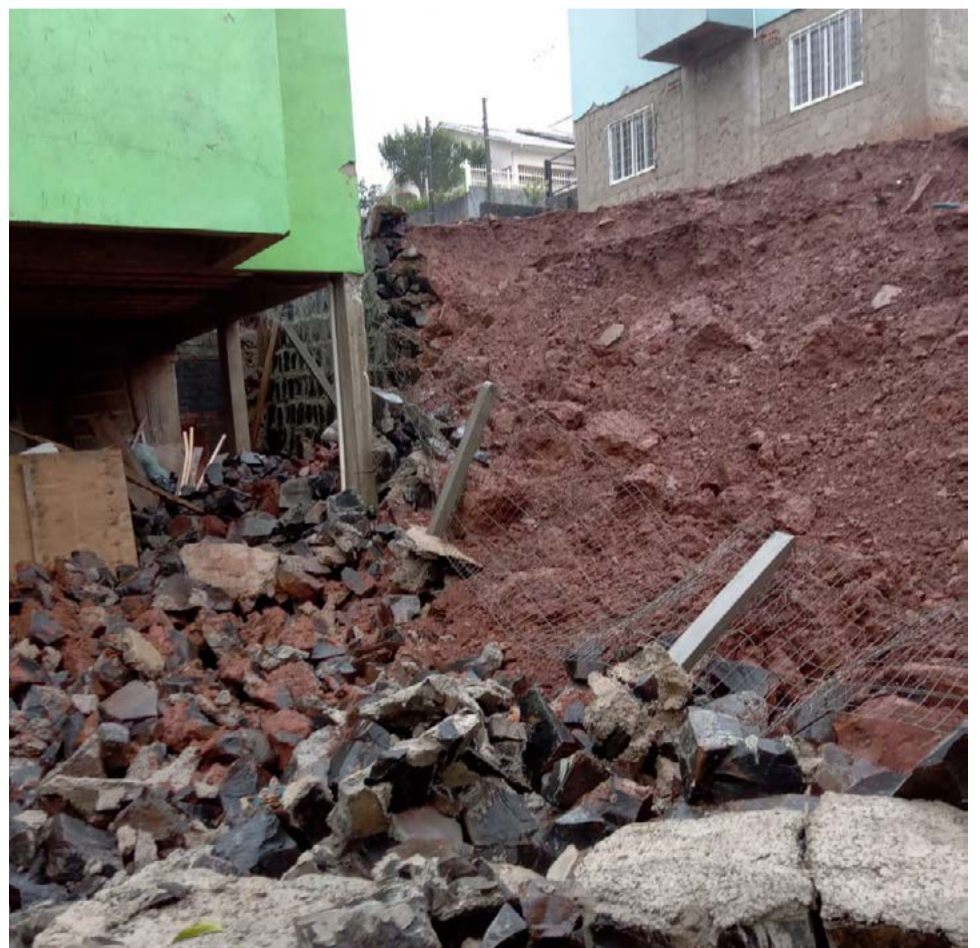
Um muro desabou após acúmulo de água em Saudades
