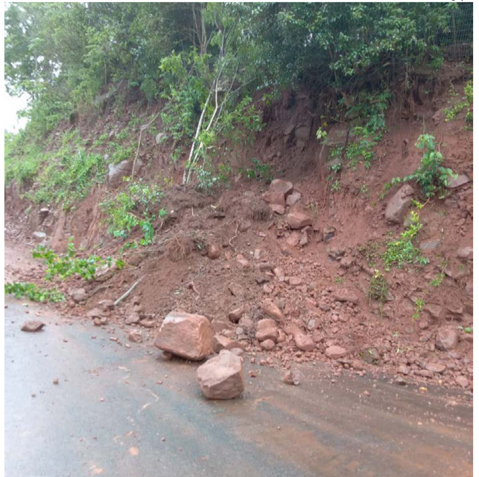
Em Saudades, registro de deslizamento de terra
