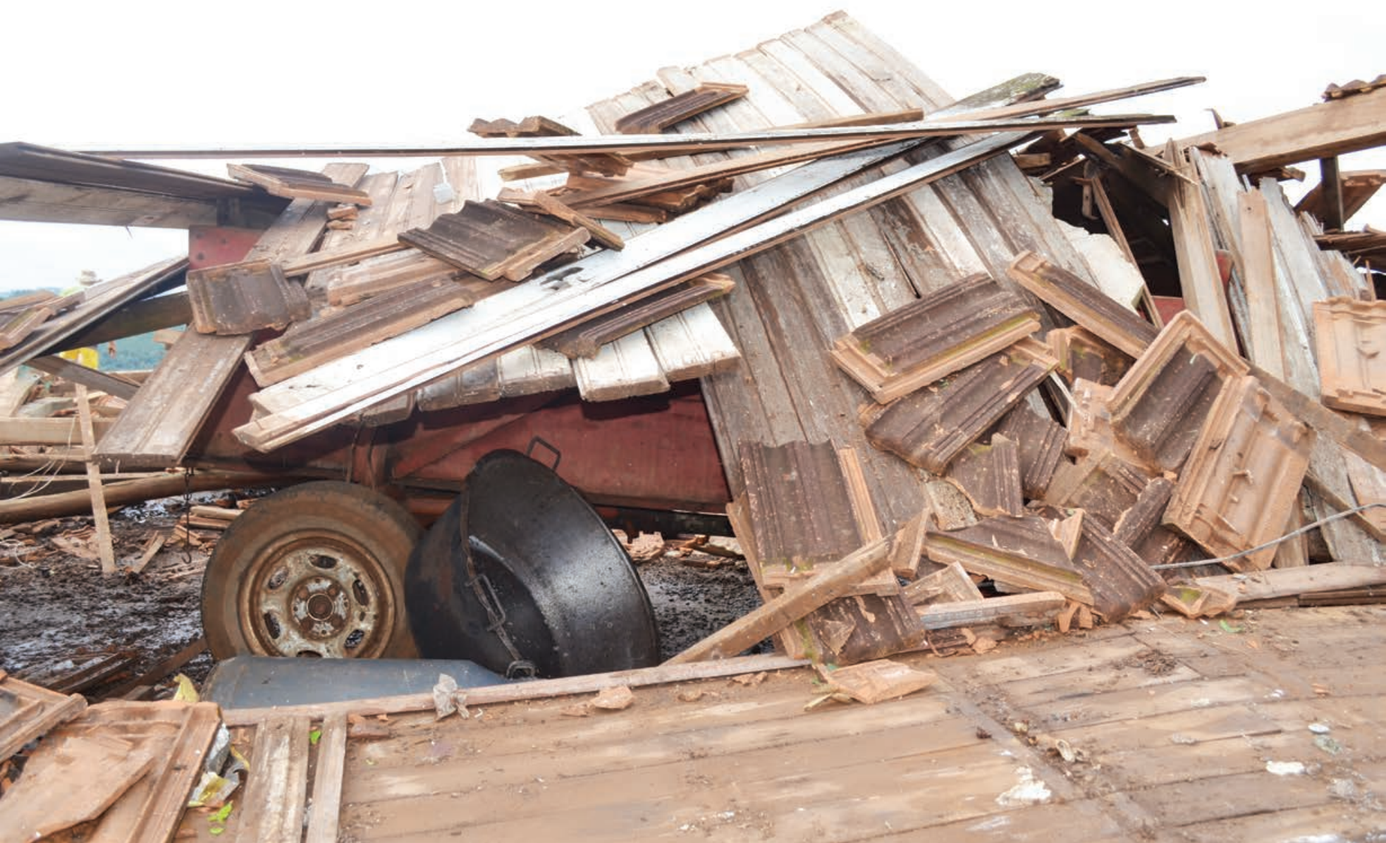
O galpão onde a família guardava um trator ficou completamente destruído
