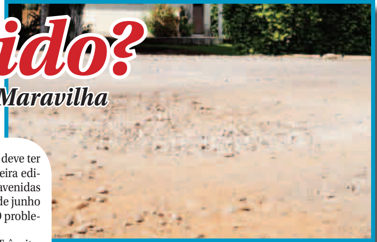
Rua Cândido Rondon, do Bairro Civismara, está com britas para tapar os buracos
