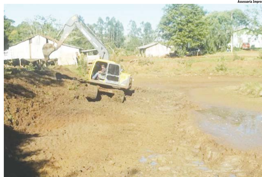
Entre as ações, a Secretaria de Agricultura realiza a limpeza de reservatórios, abertura de valas para instalação de rede e cede caixas de água
