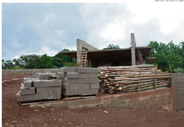
Cemitério voltou a ter obras paralisadas. Esta é a segunda vez no ano
