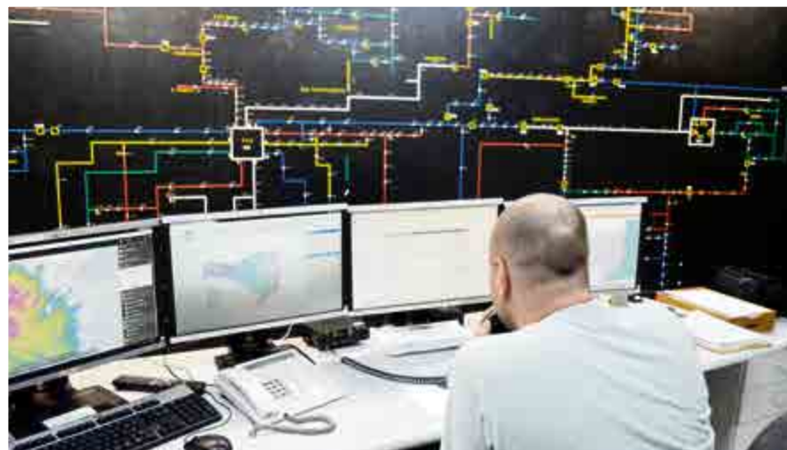
Central de Operação de Distribuição da Celesc em São Miguel do Oeste, que atende 33 municípios do Extremo-Oeste e monitora cinco subestações de energia
