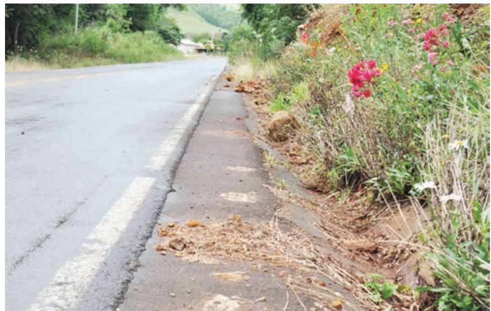
A falta de acostamento adequado é outro problema apresentado pelas rodovias estaduais SC-492 e SC-497
