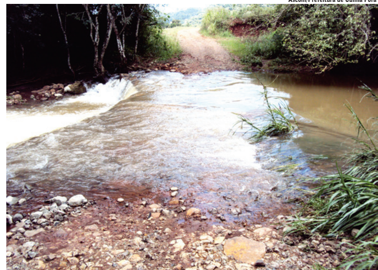
Ponte sobre o Rio São Domingos foi afetada
