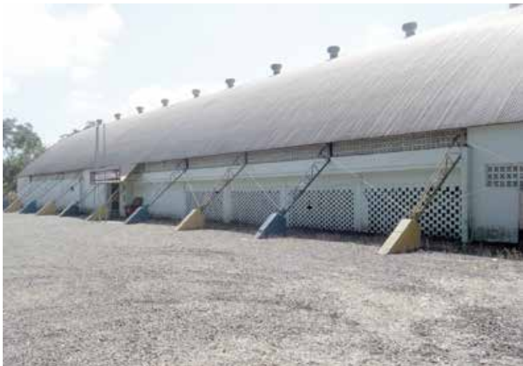
Ginásio está atualmente em condições precárias
