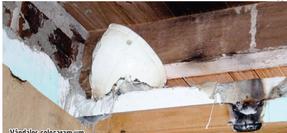
Vândalos colocaram um balde de lixo no forro do banheiro e colocaram fogo
