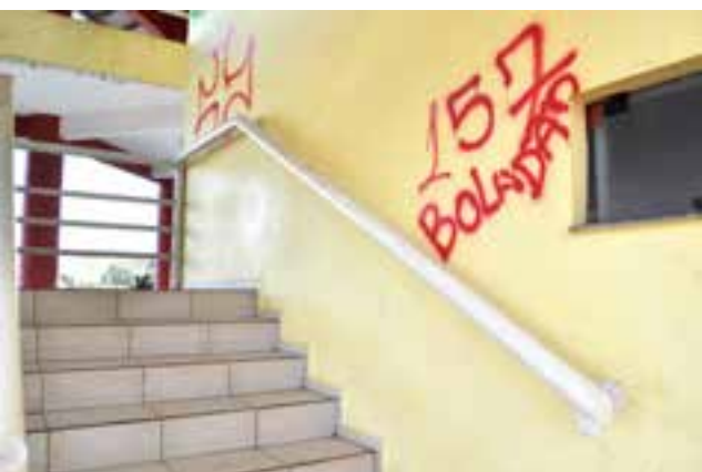
Paredes da escada que dá acesso ao segundo pavimento da edificação também foram pichadas
