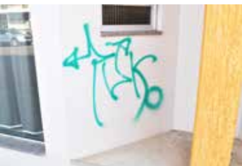
Paredes da edificação da empresa Rapanui também foram pichadas
